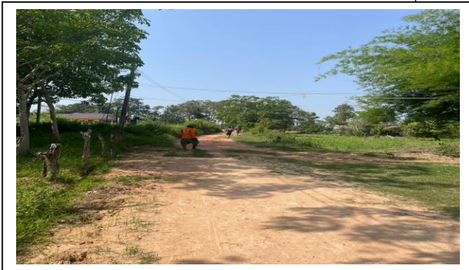
๘. ก่อสร้างถนนคอนกรีตเสริมเหล็กสายทางบ้านนายขุน อ่ำภา หมู่ที่ ๖
